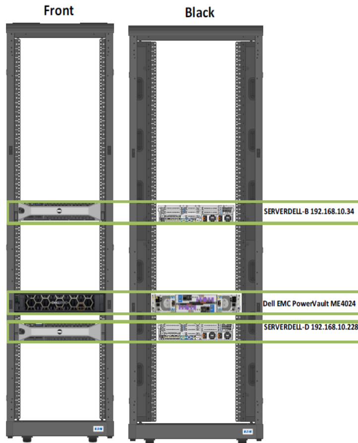
Ilustración 3 – Instalación Física en Rack
